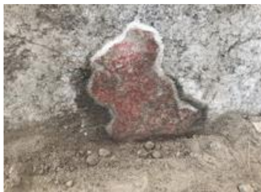
Figura 3.4. Fragmento de pintura mural in situ, ya con el ribete de protección.
